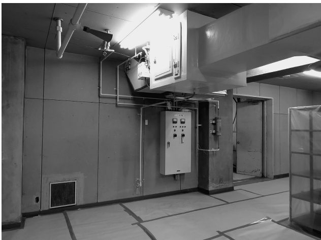
自然収蔵庫 空調機器、入口
