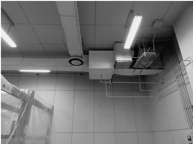
考古収蔵庫 空調天井部・吹き出し口
